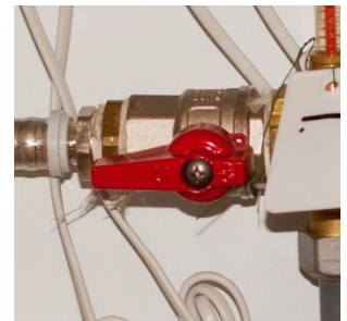
Bild 6. Kulventil på inloppsriör
